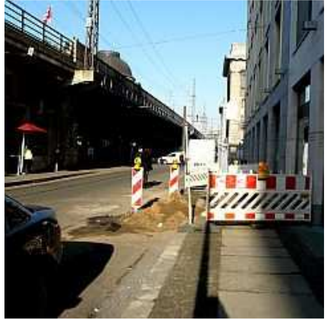
Foto 12: ... und nichts überwacht.
