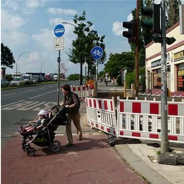
Foto 29: Baustellen-Umgehungen haben leider häufig keinen geregelten Anfang ...
