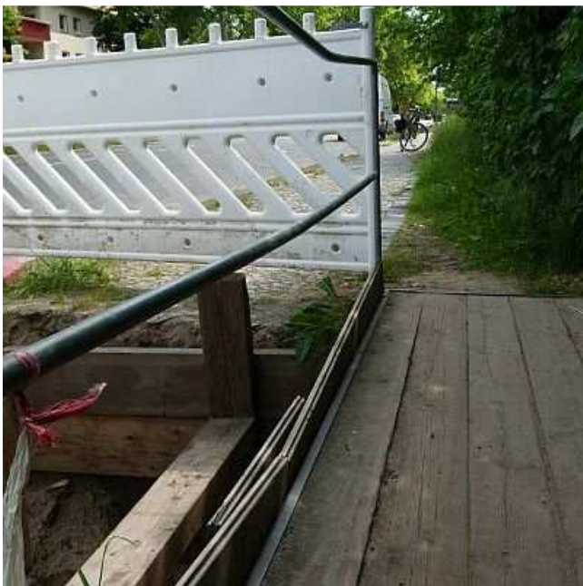
Foto 15: Trotz Mittelstrebe gibt es ein Loch zum Durchfallen von 44 Zentimetern ...
