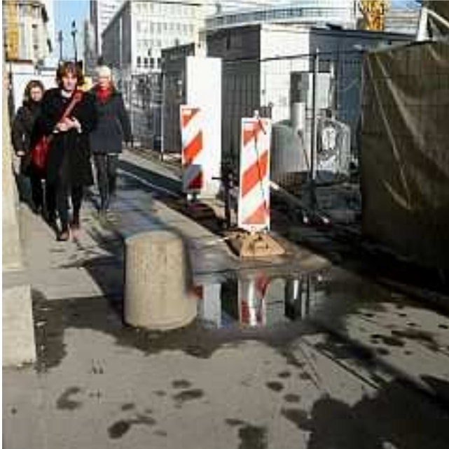
Foto 11: Hier wurde nichts überprüft...
