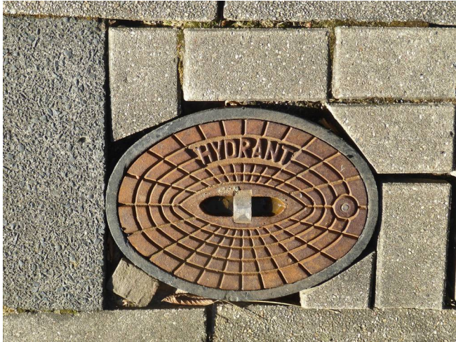
Bild 14: Hydranten im Gehweg benötigt die Feuerwehr.
