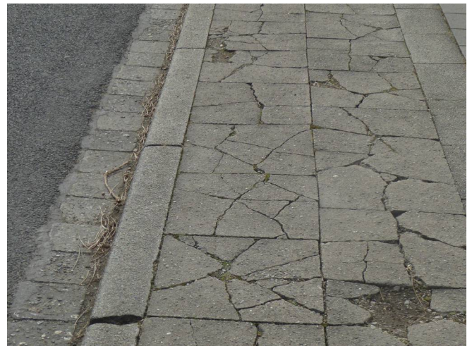
Bild 11: Typische Gehwegschäden durch zu schwere Fahrzeuge
