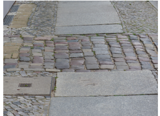
Die sehr unebene Pflasterung ist außerordentlich negativ aufgefallen und macht es Personen, mit eingeschränkter Mobilität, besonders schwer diese Straße zu durchqueren.
